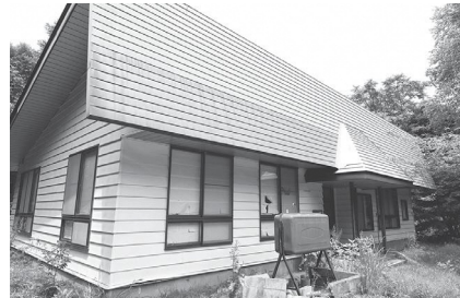
老朽化した天栄村立湯本中学校寄宿舎
