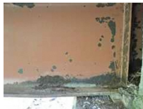
59. 胡桃沢橋：鋼H桁橋 (橋長：15.3m、1965年竣功) 主桁端部の板厚減少を伴った腐食 ※支点上での板厚減少は、耐荷力の低下が推測される。(迂回路有)
