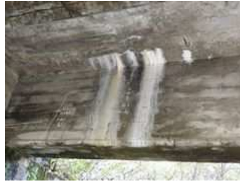
91. 第2牧本橋：RCT桁橋 (橋長：12.5m、1958年竣功) 床版下面の錆汁を伴った遊離石灰 ※内部鉄筋の腐食の進行は、耐荷力の低下に影響する。(迂回路無)
