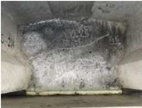
62. 大徳坊2号橋：プレテンT桁橋 (橋長：14.8m、1984年竣功) 端横桁の錆汁を伴った遊離石灰 ※内部鋼材の腐食の進行は、耐荷力の低下に影響する。(迂回路有)
