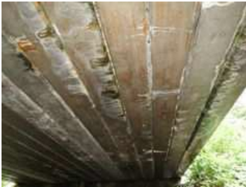
111. 布引4号橋：プレテン床版橋 (橋長：6.6m、1976年竣功) 間詰め部の錆汁を伴った遊離石灰 ※内部鋼材の腐食の進行は、耐荷力の低下に影響する。(迂回路無)
