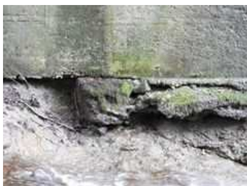
106. 母子沢橋：鋼H桁橋 (橋長：11.48m、1967年竣功) A2橋台基礎部の洗掘 ※基礎部の洗掘により、鉛直支持機能の低下が推測される。(迂回路無)
