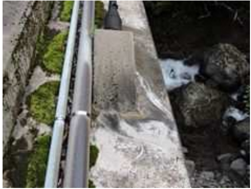
55. 二俣橋：斜張橋 (橋長：31.6m、2008年竣功) ケーブル定着部の錆汁を伴った遊離石灰 ※内部鋼材の腐食の進行は、耐荷力の低下に影響する。(迂回路有)
