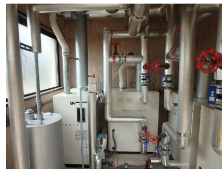
左) エネルギー高効率熱源機器
