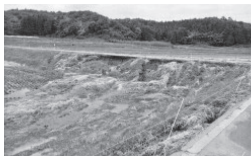
南沢地区の道路法面の崩落
