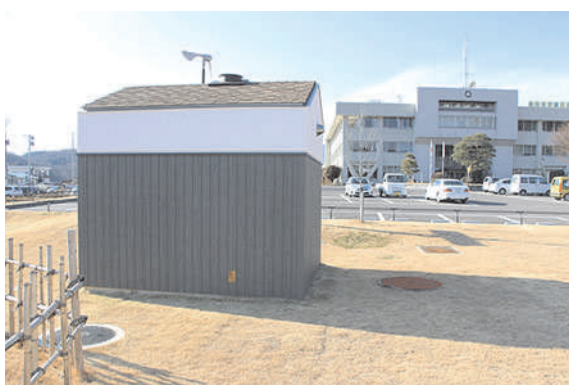
耐震性貯水槽
