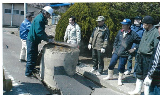
隆起したマンホール
