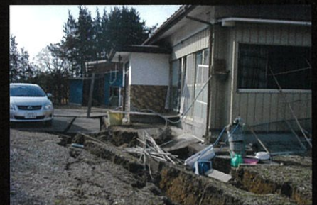
沖内地区の宅地地割れ
