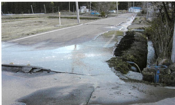
震災直後の竜生地区水道漏水の様子
