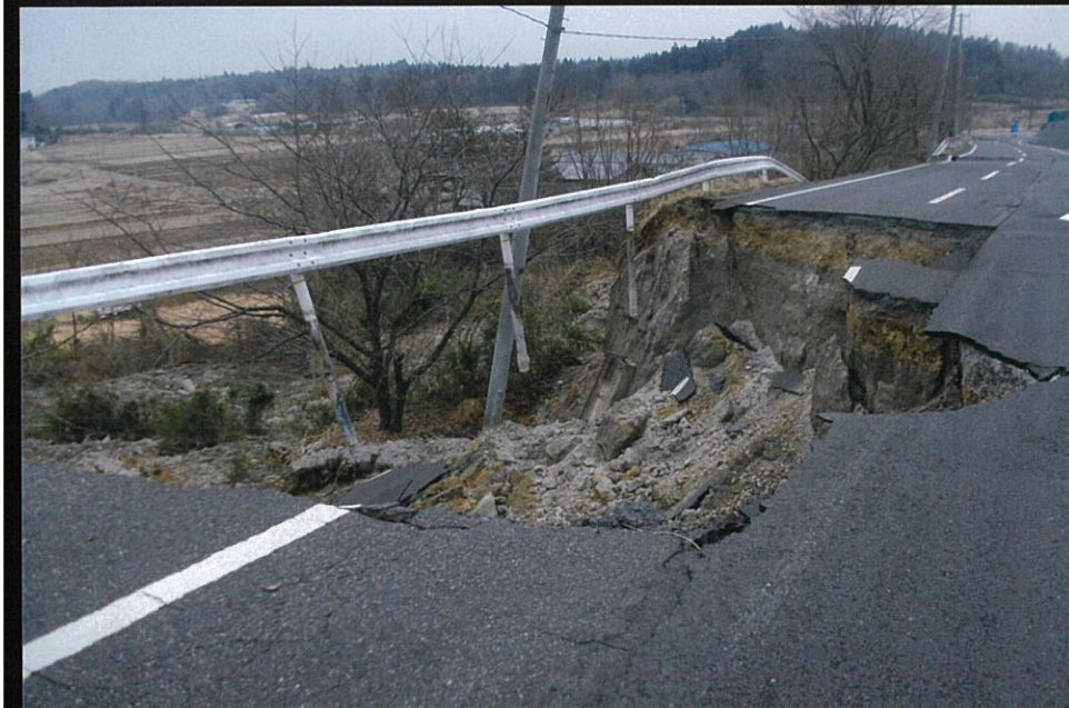
大山地区の道路崩落
