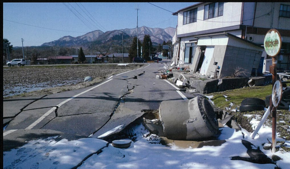
滝田地区の道路亀裂、マンホール損壊
