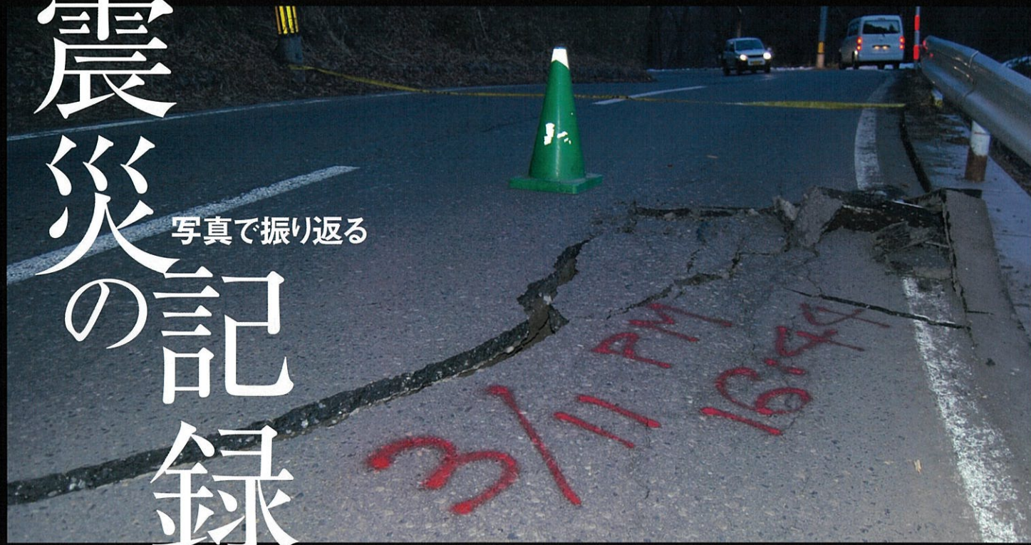
亀裂が入り通行止めとなった国道118号
