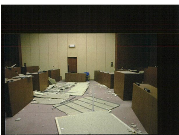
天井が落下した講場
