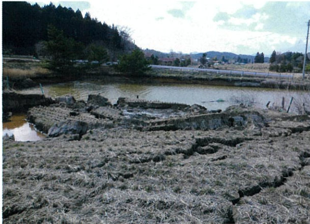
ため池の破損
