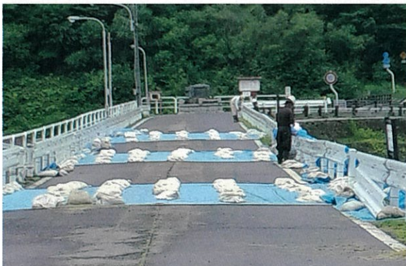
羽鳥ダムで行われた応急処置
